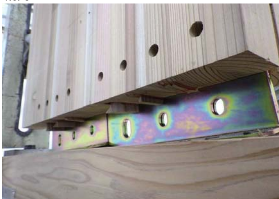
鉛直材の割れ
