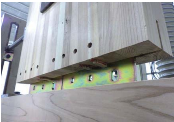
鉛直材の割れ
