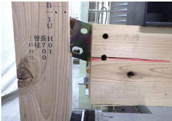
横架材の割れ(1. 2ch側)
