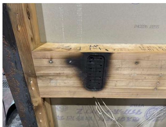
写真 3.1.3-1-12 解体時・梁スギ被覆 (試験体 1-1・仕様 1)
