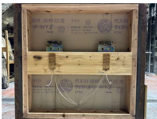
写真 3.1.3-3-11 解体時・梁表面 (試験体 3-1)
