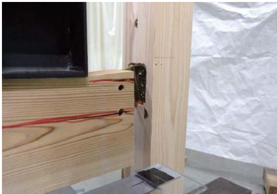
横架材の割れ(3. 4ch側)
