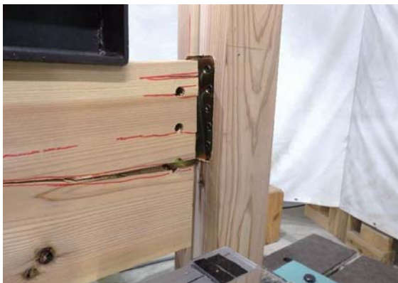
横架材の割れ(3. 4ch側)
