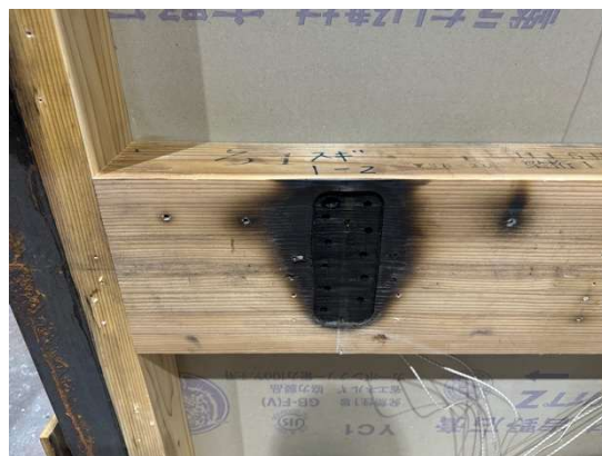
写真 3.1.3-1-16 解体時・梁スギ被覆 (試験体 1-2・仕様 3)
