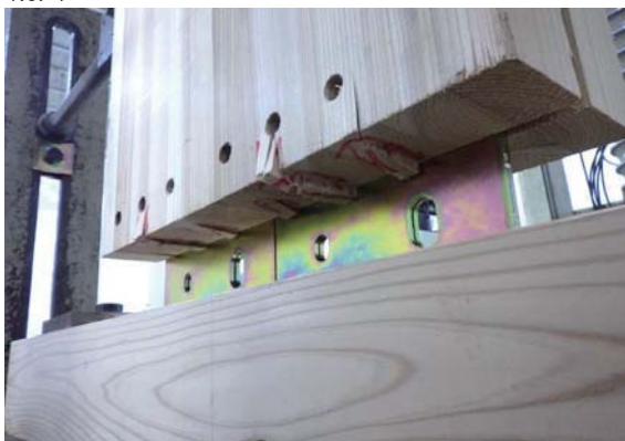
鉛直材の割れ
