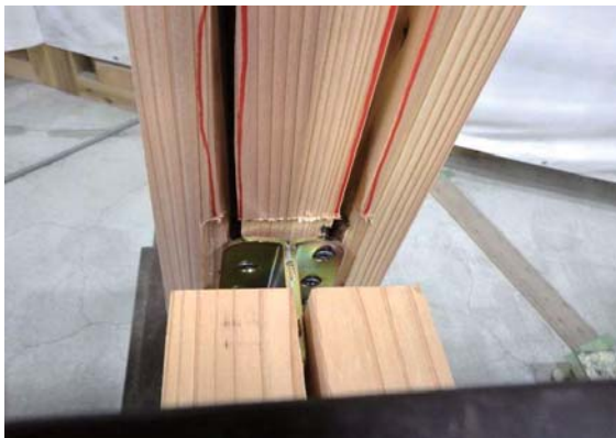
鉛直材の割れ (3. 4ch側)
