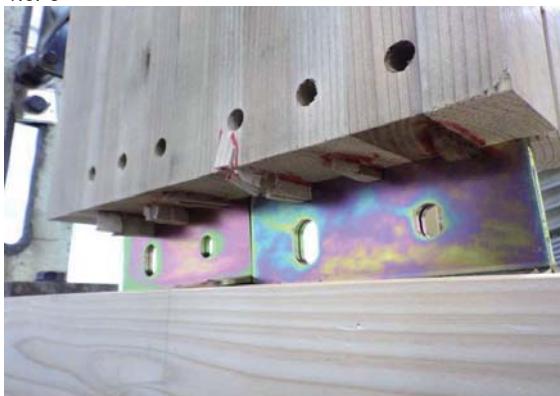
鉛直材の割れ
