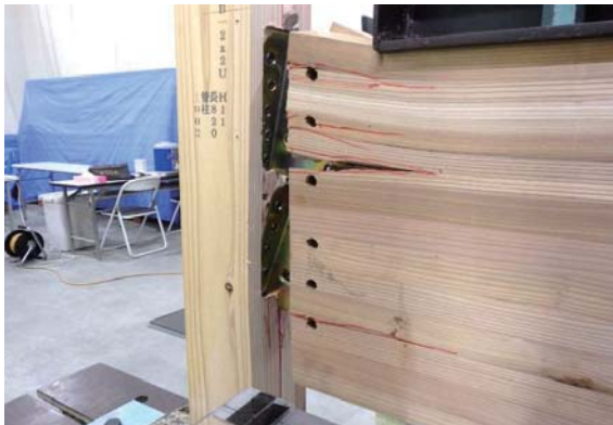
横架材の割れ (1. 2ch側)
