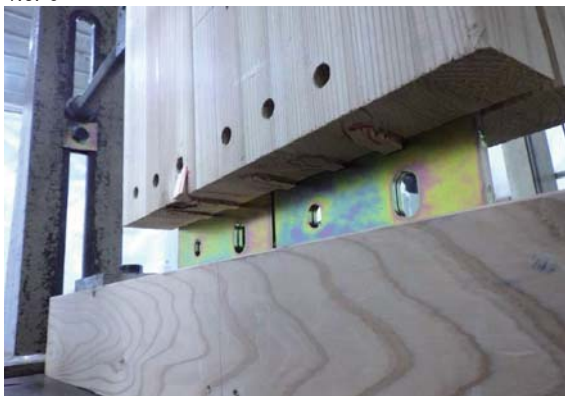
鉛直材の割れ
