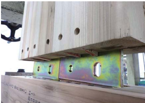
鉛直材の割れ
