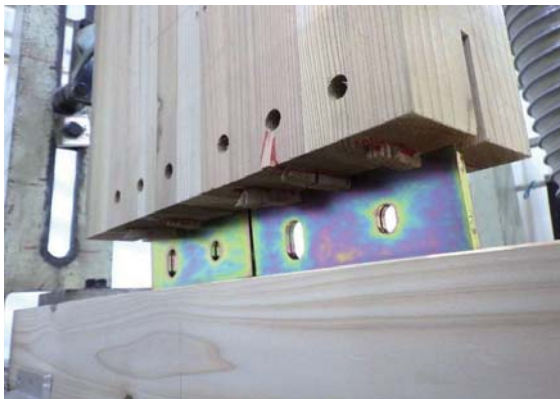
鉛直材の割れ
