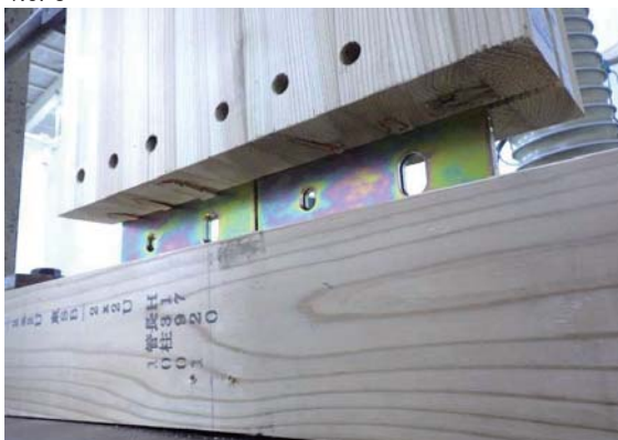
鉛直材の割れ
