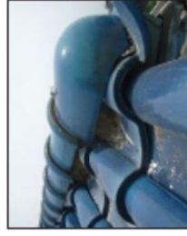
▲面戸のモルタルの割れ
