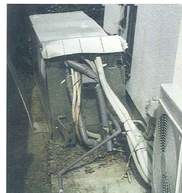
熊本地震で転倒した貯湯タンクの一例
